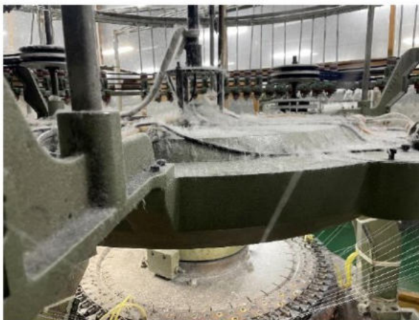
機台上方容易產生棉絮導致機體故障
